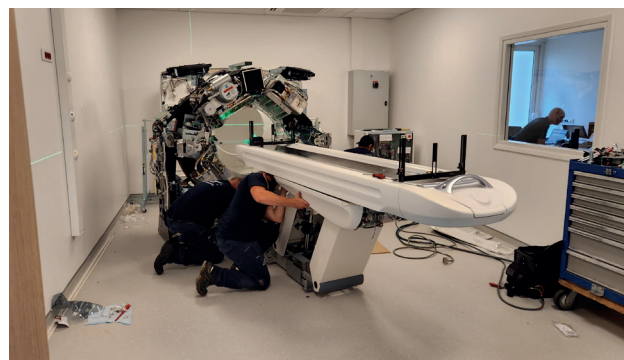
Le scanner Revolution Maxima dédié aux urgences a été installé le 9 septembre 2024 et a accueilli ses premiers patients le 18 novembre 2024.
